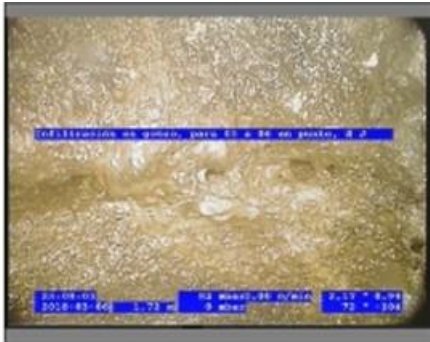
Foto: 1_3A 1,72m, Infiltración en goteo, para 03 a 06 en punto, # J / Se recomienda realizar la reparación puntual
