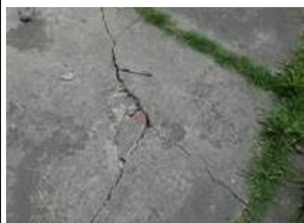
Foto No. 5 Rompimiento del hormigón y abombamiento por migración del suelo plástico.
