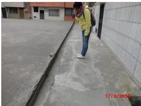
Foto No.4 Levantamiento en forma de ola, en calzada por reajuste del material plástico
