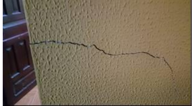
Foto No. 21 Fisuras moderadas a graves en casa Oe4-153
