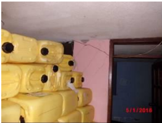
Foto No. 34 Fisuras graves abiertas en paredes interiores de casa Oe4-180 del Pasaje S22
