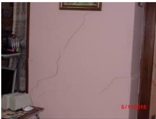
Foto No. 30 Fisuras abiertas en pared interior de casa Oe4-163
