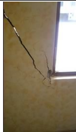
Foto No. 25 Fisuras graves abierta en casa Oe4-163
