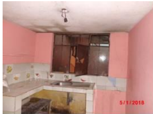
Foto No. 35 Fisuras moderadas en paredes interiores y rotura de vidrios de casa Oe4-180, Pasaje S22
