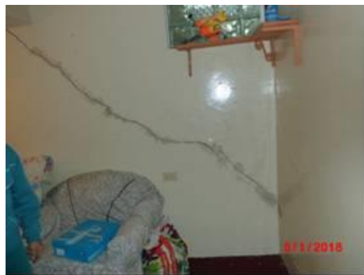
Foto No. 31 Fisuras abiertas y desplazadas en paredes interiores compartidas casa Oe4-163
