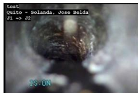
Foto: 6_A 7m, Alineación Izquierda Abajo, 15 % / Se recomienda realizar la reparación total.
