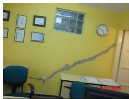
Foto No. 29 Fisuras abiertas y desplazadas en paredes interiores casa Oe4-163
