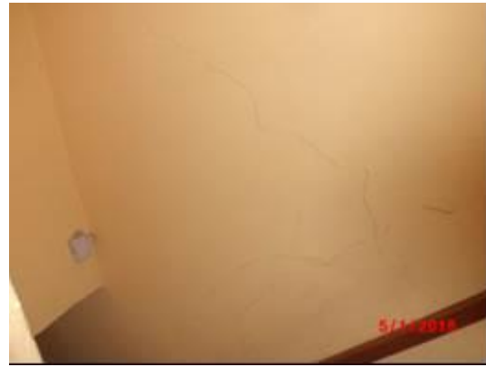
Foto No. 33 Fisuras leves a moderadas en paredes interiores compartidas casa Oe4-144, Pasaje S22
