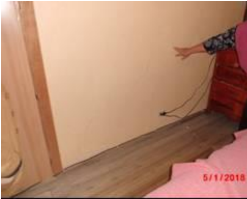
Foto No. 26 Fisuras moderadas en pared compartida casa S21-95
