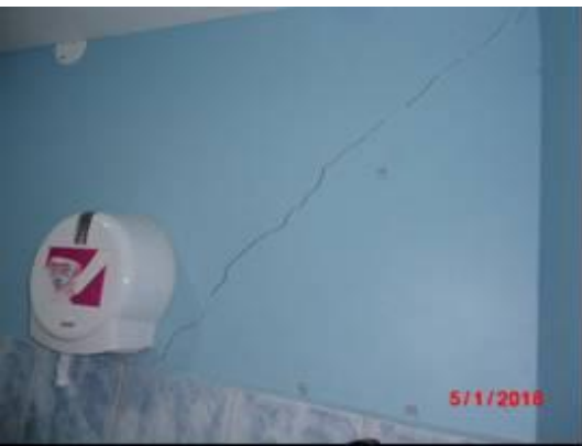
Foto No. 28 Fisuras abiertas en pared interior de casa Oe4-153
