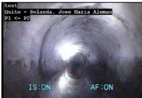
Foto: 1_4A 0m, Fractura longitudinal, en 09 en punto, within 200mm of joint: NO, Arrancar / Se recomienda la reparación total del tramo.
