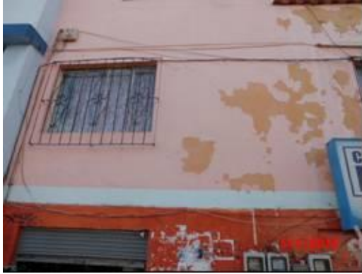
Foto No. 32 Fisuras leves en fachada de casa Oe4-144 del Pasaje S22
