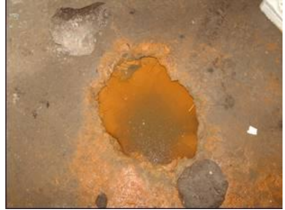
Foto No. 8 Presencia de nivel freático en superficie.
