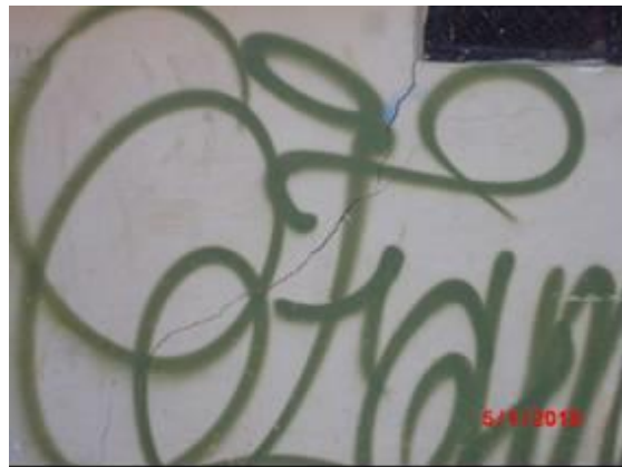
Foto No. 27 Fisuras graves abierta en fachada de casa Oe4-153
