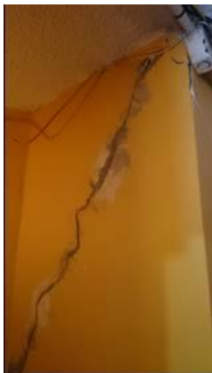
Foto No. 24 Fisuras graves en casa Oe4-163, pasa al otro lado
