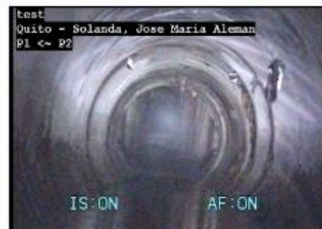
Foto: 1_5A 30m, Fractura longitudinal, en 09 en punto, within 200mm of joint: NO, Acabado / Se recomienda la reparación total del tramo.
