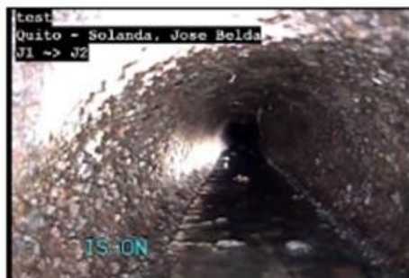
Foto: 5_A 0m, Agregado Protuberante por causa desconocida, para 12 a 12 en punto, within 200mm of joint: NO / Se recomienda realizar la reparación total.
